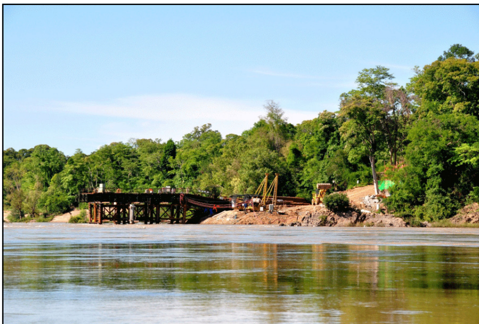
Tại vị trí xây dựng Đập Don Sahong, Lào đã làm cầu dẫn thi công bên bờ sông (Ảnh chụp vào tháng 6/2014 – Nguồn: International Rivers)
