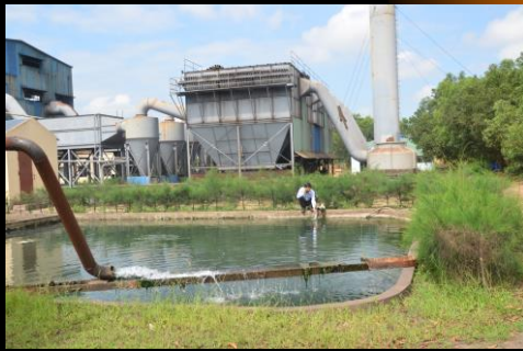
Hệ thống xử lý khí thải
