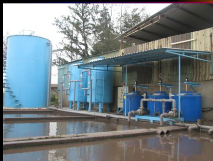
Hệ thống xử lý nước tuần hoàn
