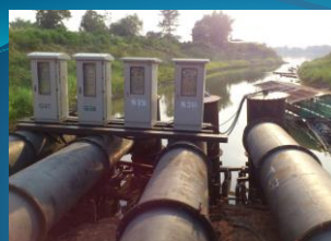
Bốn máy bơm đã chiến hút nước từ sông Mê Công
