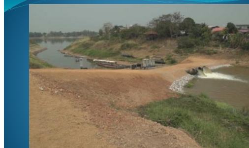
Các máy bơm đang vận hành (bơm nước từ sông Mê Công)
